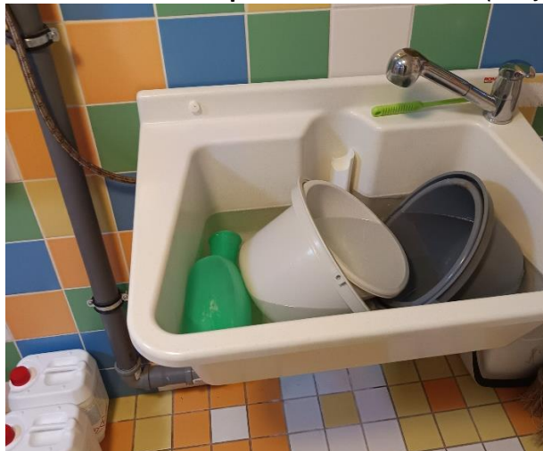
pochybení: nedostatečná dezinfekce
